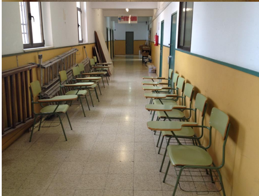
IMAGEN 7 y 8. Dificultad para visualizar las señalizaciones de evacuación y de equipos de lucha contra incendios
