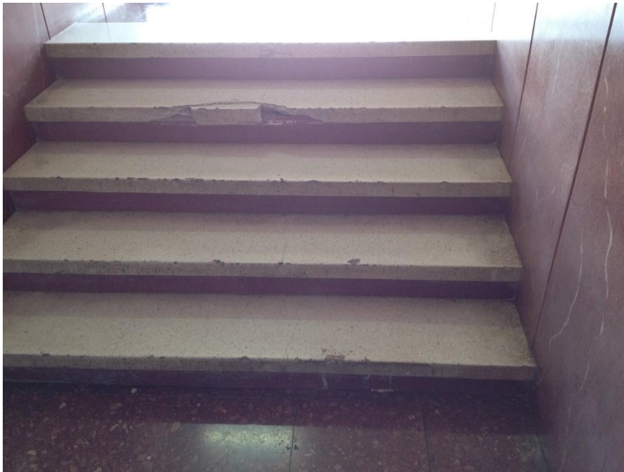
IMAGEN 9. Huellas rotas en la escalera.
