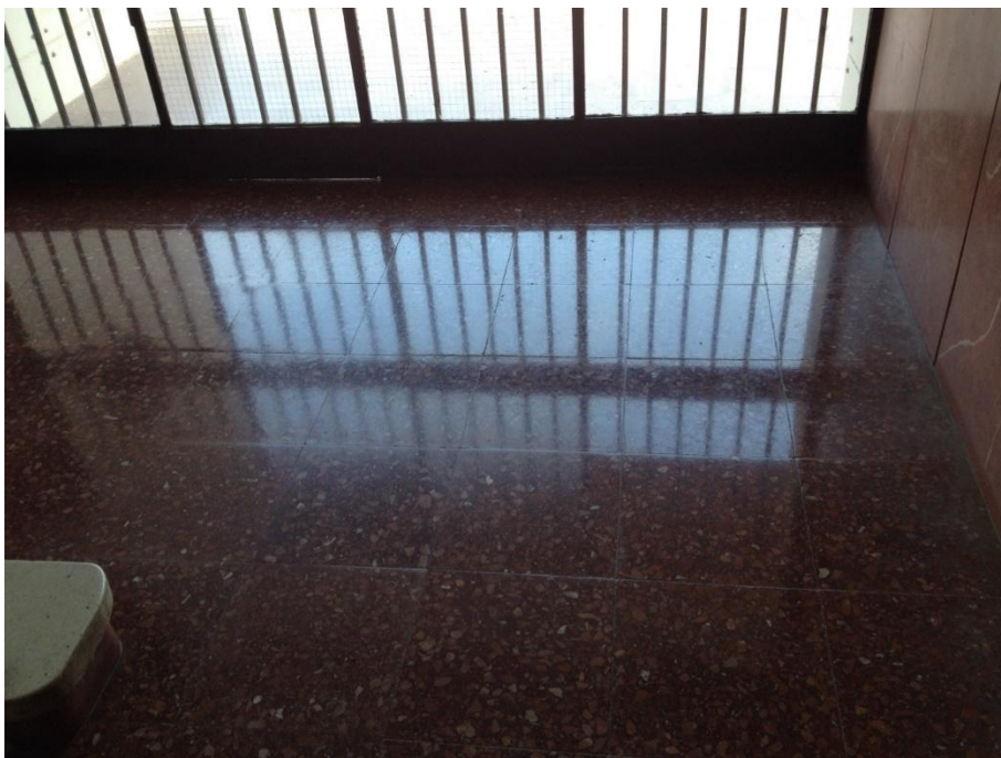
IMAGEN 10. Resbaladidad en accesos al edificio
