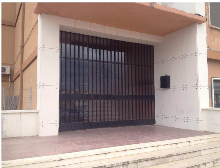
IMÁGEN 1 y 2. Accesos al edificio permanentemente cerrados
